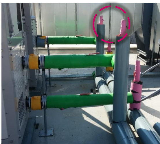
Na rurze dopływu/ odpływu wody pompy ciepła
